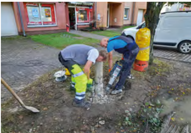
Pan Pavel a Radek z TS při rozbíjení základů původního stožáru VO
