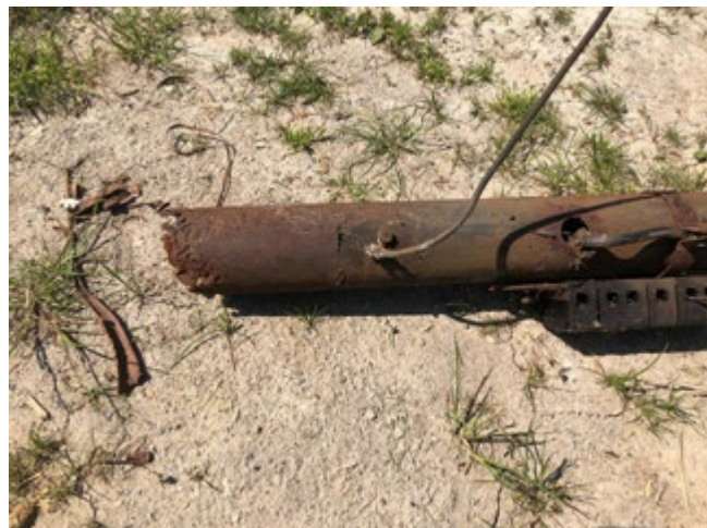
Korozí postižený stožár lampy veřejného osvětlení
