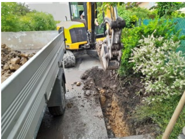
Výkopové práce u havárie v ulici Větrná
