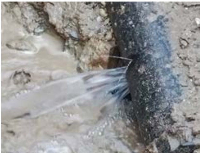
Prasklina na vodovodním řadu
