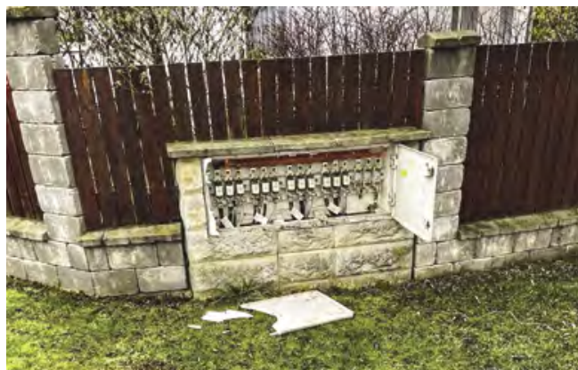
Zničená dvířka rozvaděče v ulici Manželů Starých
