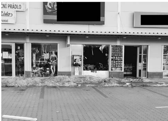
Výbuch poškodil i okolní obchody
